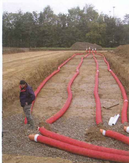
Des puits canadiens ont été enfouis dans le sol
