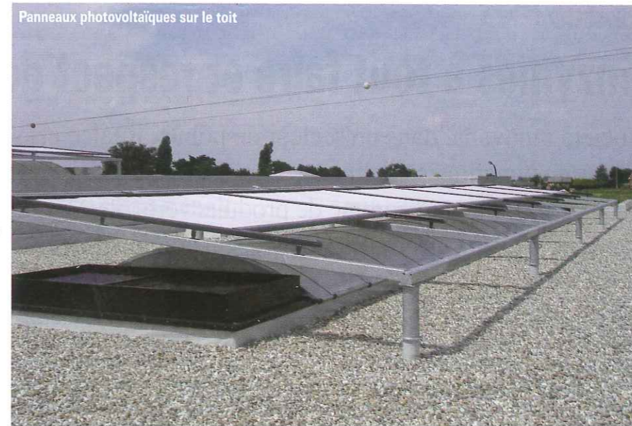
Panneaux photovoltaïques sur le toit
